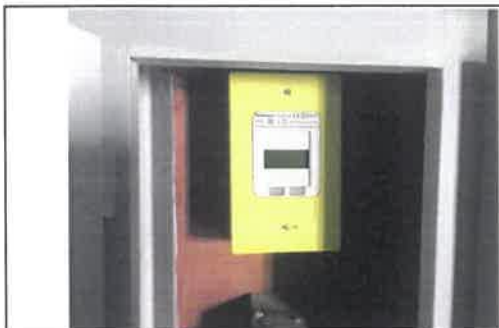
Photo du Compteur électrique
