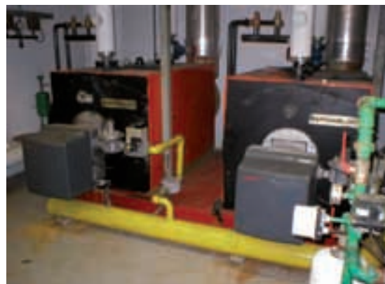
Chaufferie de la piscine avant l'été 2008 avec un rendement d'exploitation de 80 %.
