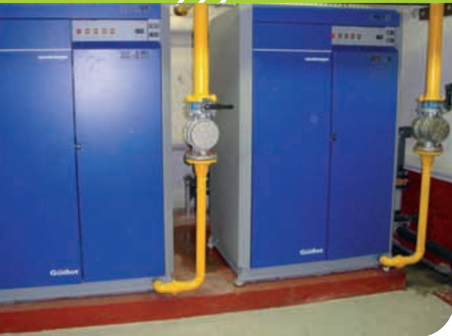
Les nouvelles chaudières de la piscine avec un rendement d'exploitation de 95 %. Sur un parc communal de 70 chaudières, ce sont 40 chaudières qui seront remplacées par des chaudières performantes à condensation et à haut rendement.
